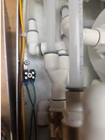
Sensore di perdite Morsettiera nera con 2 cavi Verdi
